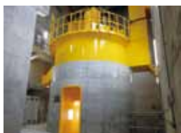
水車発電機全景
