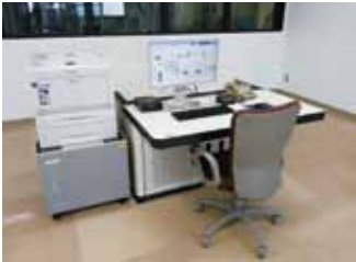
汚泥棟 中央監視装置
