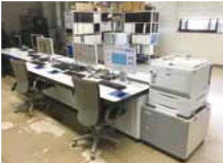
管理棟 中央監視装置
