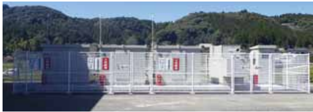
非常用電源設備全景
