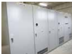
キュービクル全景
