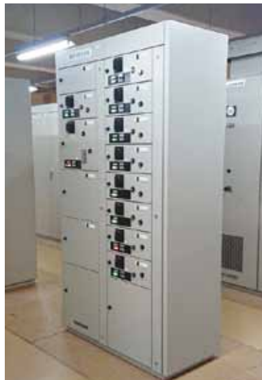
コントロールセンター
