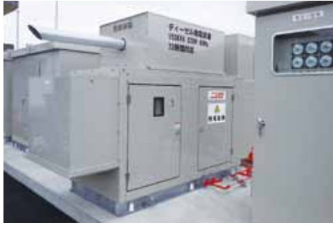
ディーゼル 発電機 150 kVA
